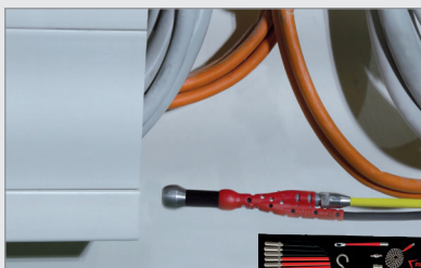
Sjakter og kanaler under gulv
